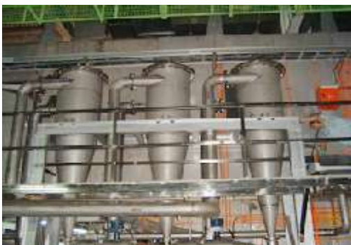
車体前処理集塵濾過装置
