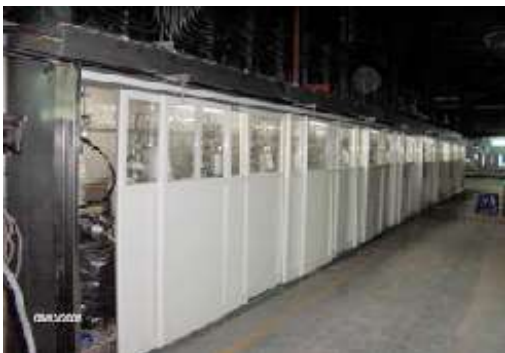
車体塗装室塗料供給装置
