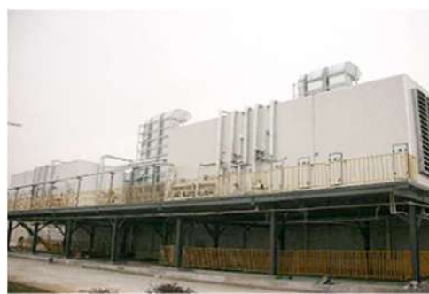
外部空調装置及び架台
