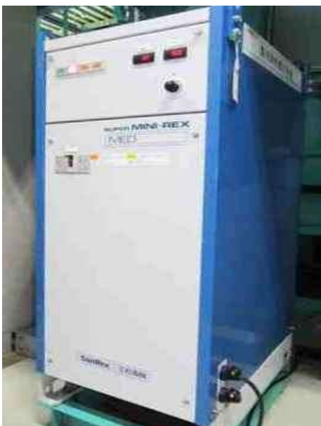
整流器制御盤(三社電機製)
