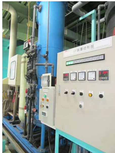
UF装置制御盤及び純水装置
