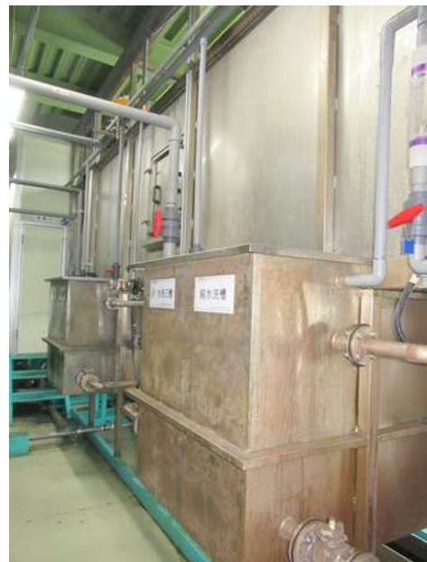
UF回収水洗3、純水槽
